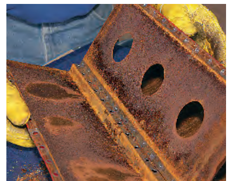
Dabei lässt es sich nicht vermeiden, dass Rost durch die Löcher in die Hauptkammer rieselt
